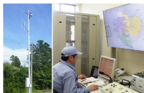
市町村防災無線設備
