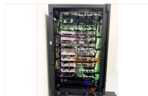
ネットワーク設備
